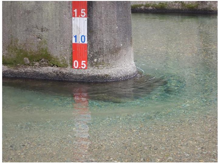
橋脚の周辺が深くえぐれているため、下に引き込む流れが発生するので、橋脚の近くでは遊ばないでください。
