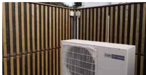
室外機周り（神奈川県）
