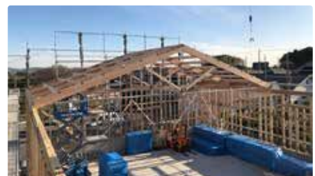
金属ブレストラス・Aバネ (水平構面・耐力壁) / 最大スパン 14.5m
