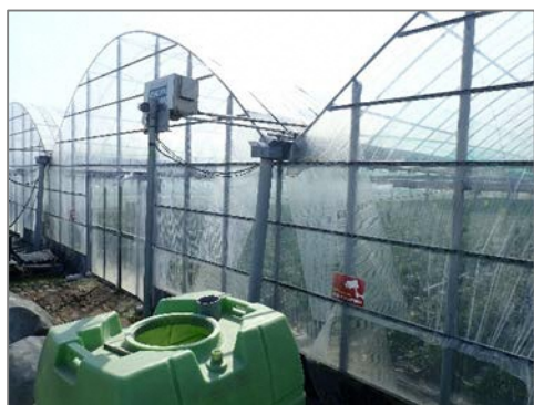
防犯カメラの設置
