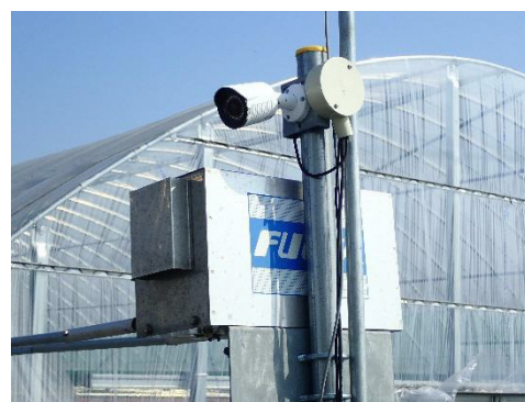
防犯カメラの設置
