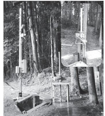
ゲートの遠隔監視・操作
