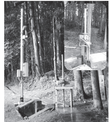
ゲートの遠隔監視・操作
