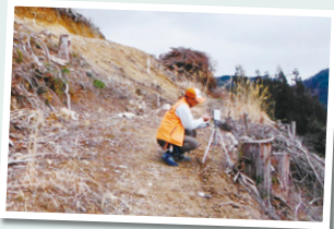
▲監視カメラ設置
