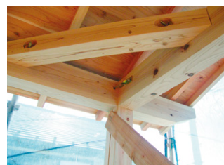
金物で建物を固める木造住宅 金物を用いた接合部。火打という斜め材で水平力を確保することもある。
