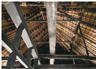
「箱木千年住宅」内観小屋組 室内を見上げたところ。木と木を組んで架構ができています。
