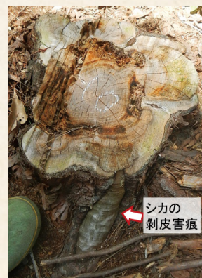
図5 シカ剥皮害痕から侵入した腐朽被害
