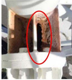
固着した腐食片を取り除いた状態の例
