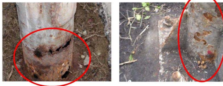
腐食片や塗装片を取り除いた状態の例
