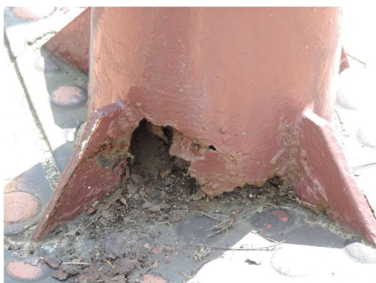
写真 3-1 支柱基部の腐食
