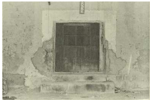
写真 3-14 御蔵入り口（修理前）
