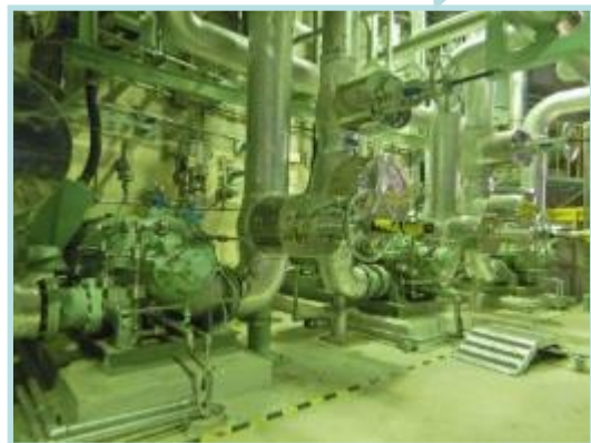
原子炉補機冷却水ポンプ
