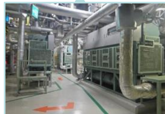
ドライウェル冷却用 チラーユニット
