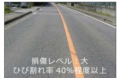
診断区分 III (修繕段階)
