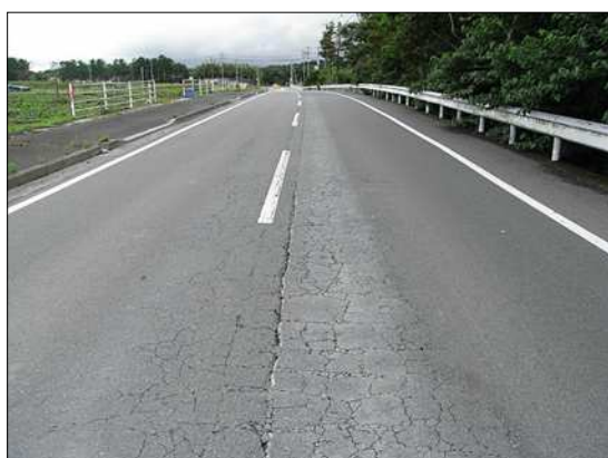
打継目の損傷例
