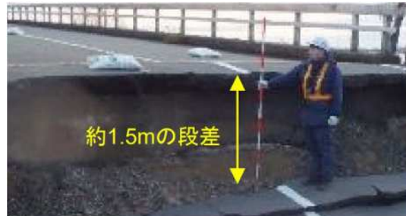
[道路と橋梁の間で発生した段差]
