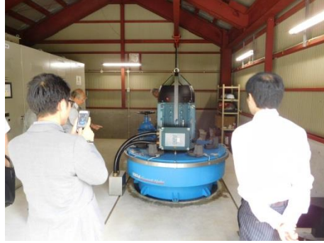
平成29年9月5日 いとしろ小水力発電設備見学
