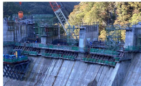
非常用洪水吐
