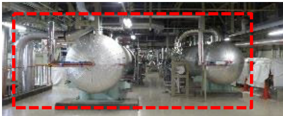
高圧第1、2給水加熱器 (解体撤去前)
