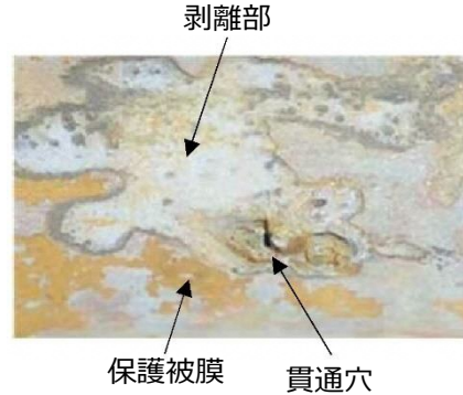
②貫通部 (伝熱管内表面)
