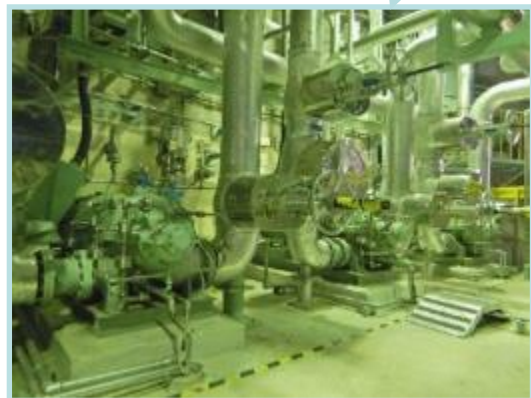
原子炉補機冷却水ポンプ
