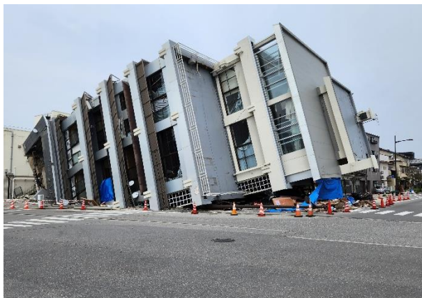
倒壊したビル
