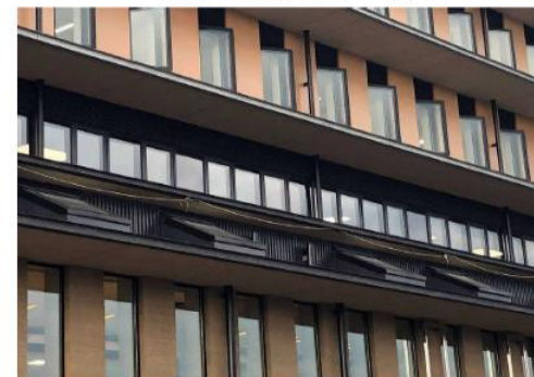
光ダクトシステムの採用
