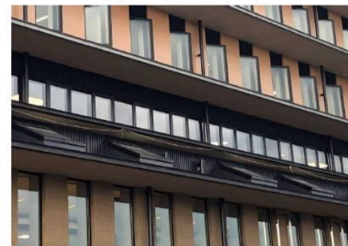
光ダクトシステムの採用
