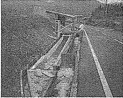
小水力発電施設
