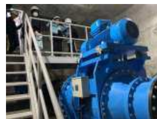
④発電施設の見学 (揖斐川町)
