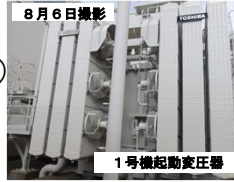
1号機起動変圧器
