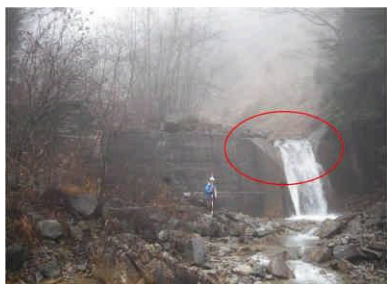
破損状況（中津川市中津川前山）
