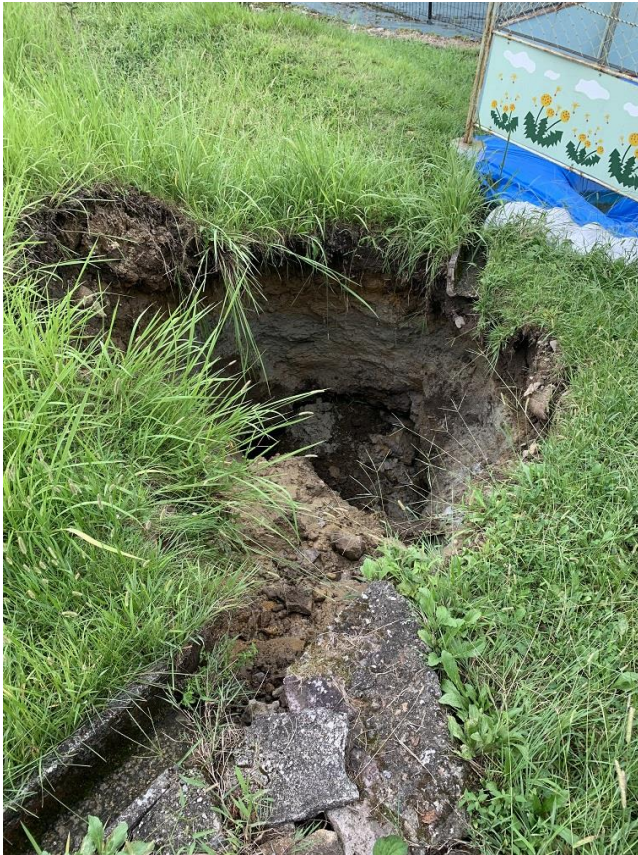
陥没箇所①
