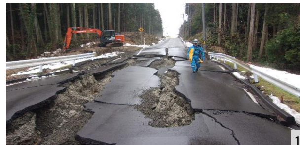
【能登半島地震：地震による道路の損壊】
