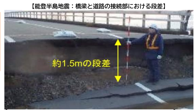
出典：R6.3.26 国土交通省「令和6年能登半島地震道路構造物（橋梁、土工、トンネル）の被害分析」
