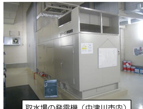
取水場の発電機（中津川市内）
