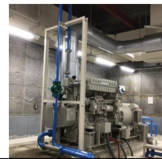
ポンプ所の発電機（中津川市内）
