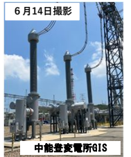
6月14日撮影 中能登変電所GIS
