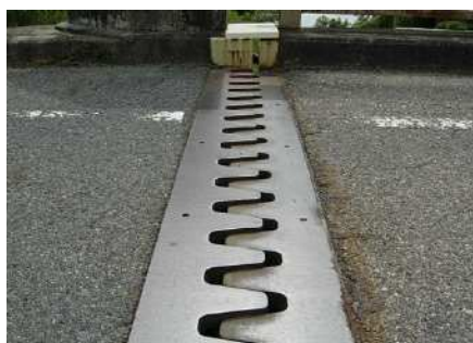
継手部の異常の確認
