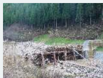
▲透過型砂防えん堤(飛騨市 殿川)
