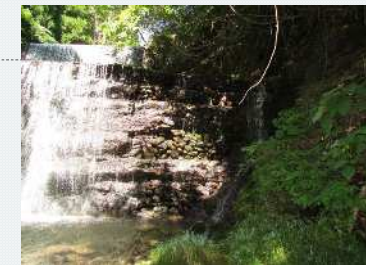
▲砂防えん堤の劣化状況 岩井谷(高山市)
