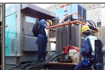
電源車実動訓練
