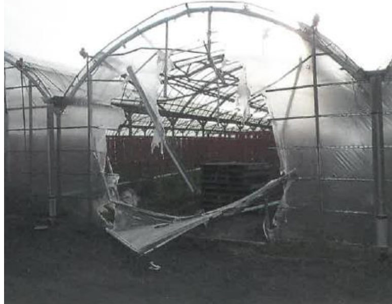
破損したビニールハウス
