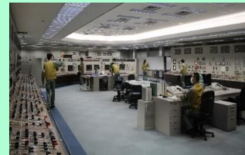
運転員の重大事故対処訓練
