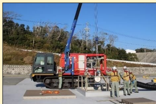
可搬型注水設備操作訓練
