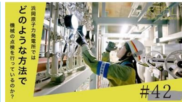
機械保修課の日常点検
