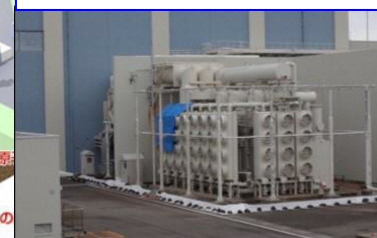
■ 2号機 主変圧器（停止中）
