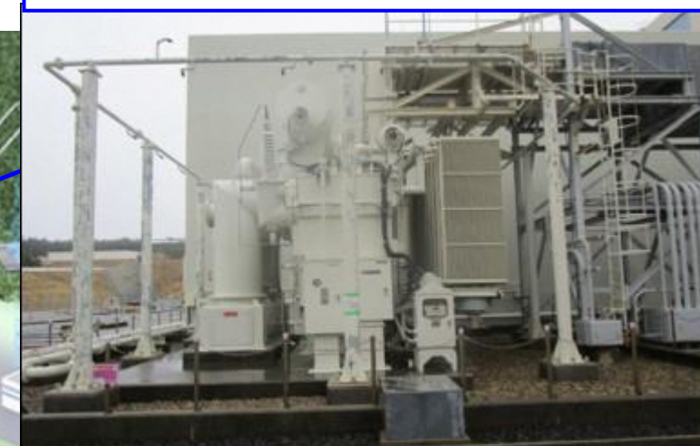
■ 2号機 予備電源変圧器
