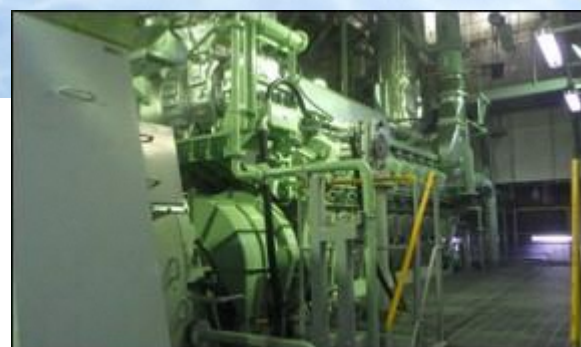
①非常用ディーゼル発電機(2号機)
