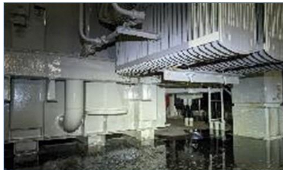
【写真：1号機起動変圧器（1/2撮影）】
