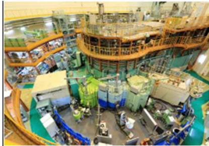
JRR-3原子炉建家内実験装置
