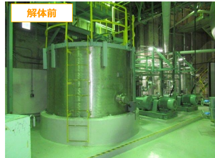
液体毒物注入系タンク
