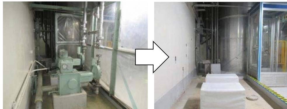
【苛性ソーダ注入装置】
