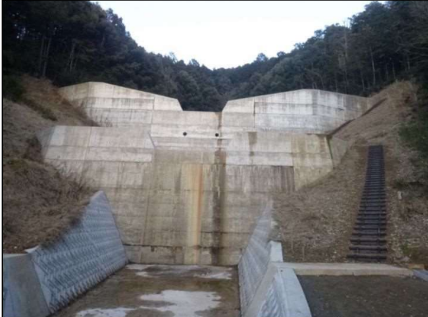
不透過型砂防えん堤
