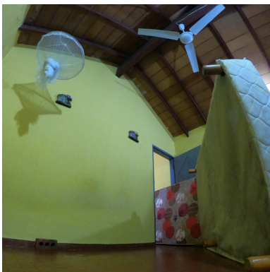
雨漏りがひどく ベッドを置く場所が無かったとき
