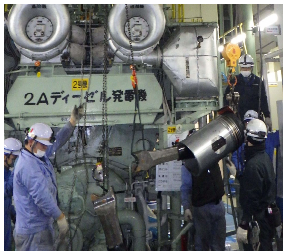
【停止時点検】 非常用ディーゼル発電機の シリンダカバー開放点検
