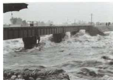
昭和37年 牛道川豪雨被災状況
