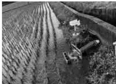
水田自動給水ゲート
