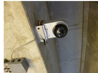
本体室天井に設置されたITV
