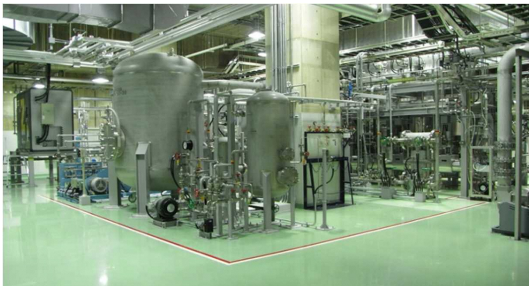
排気ガス処理システム
