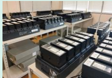
バッテリー保管・充電施設
