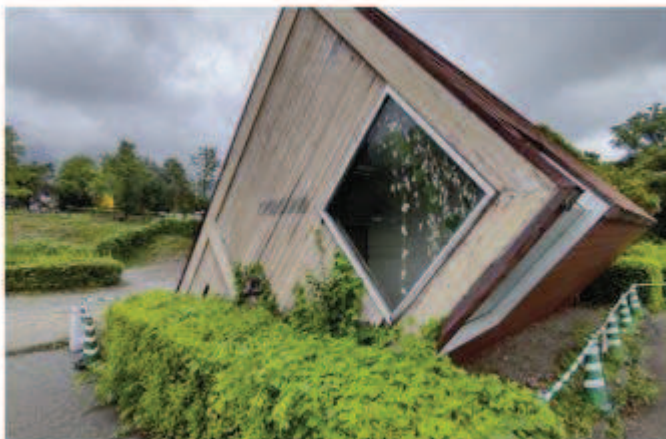
(危険建築物撤去前の状況)
