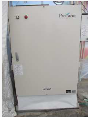
プロファーム コントローラー
