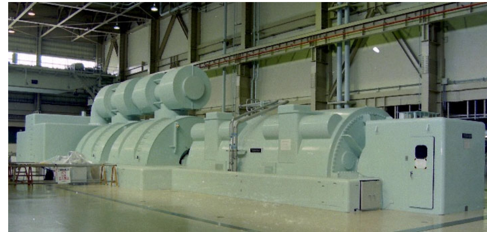
タービン発電機（タービン建物3階）
