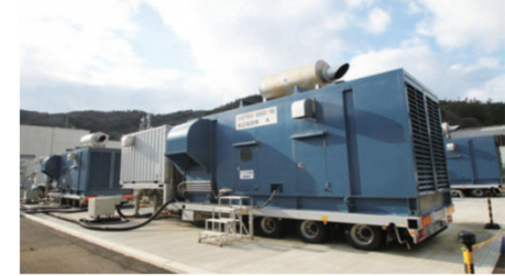
高圧電源車(1,825kVA, 3台)
